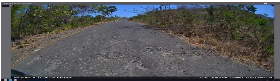
Gambar 1. Kerusakan Pada Jalan Sp. Lewogaran – Lebao – Liwo (11,5 km)
